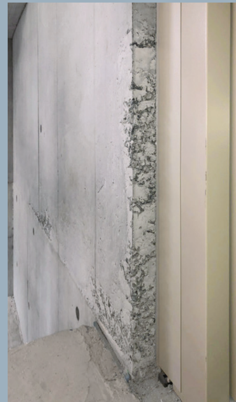
Kiesnest bei Lifttüre – vorher
