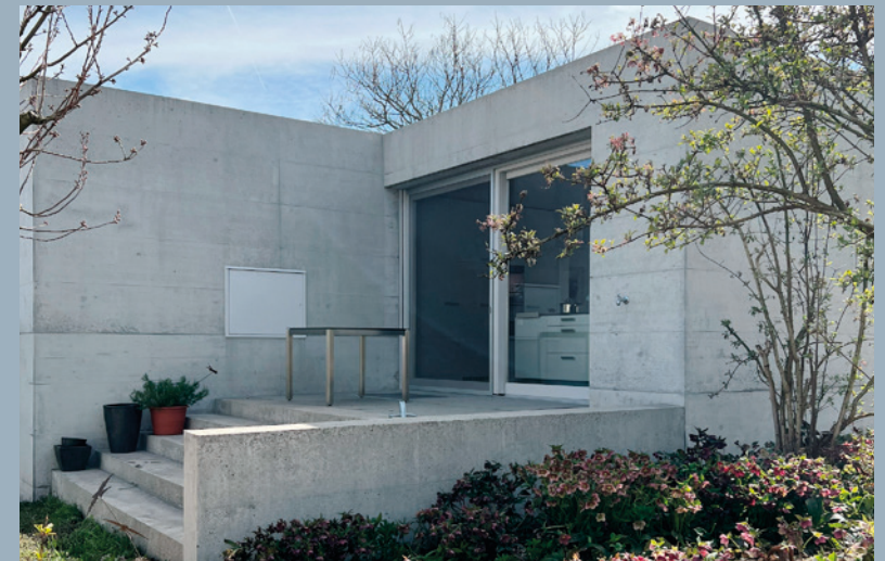
▲► Referenzbeispiel Renovation Sichtbetonfassade EFH Althäusern: Schonende Reinigung der Sichtbetonfassade mit Heisswasser-Hochdruckreiniger. Betonkosmetik und Tiefenhydrophobierung.
